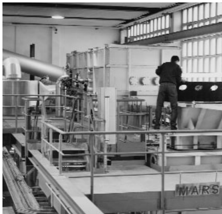
MARS: Kleinkraftwerk zur Abfallentsorgung und riesiger Gefrierschrank.
