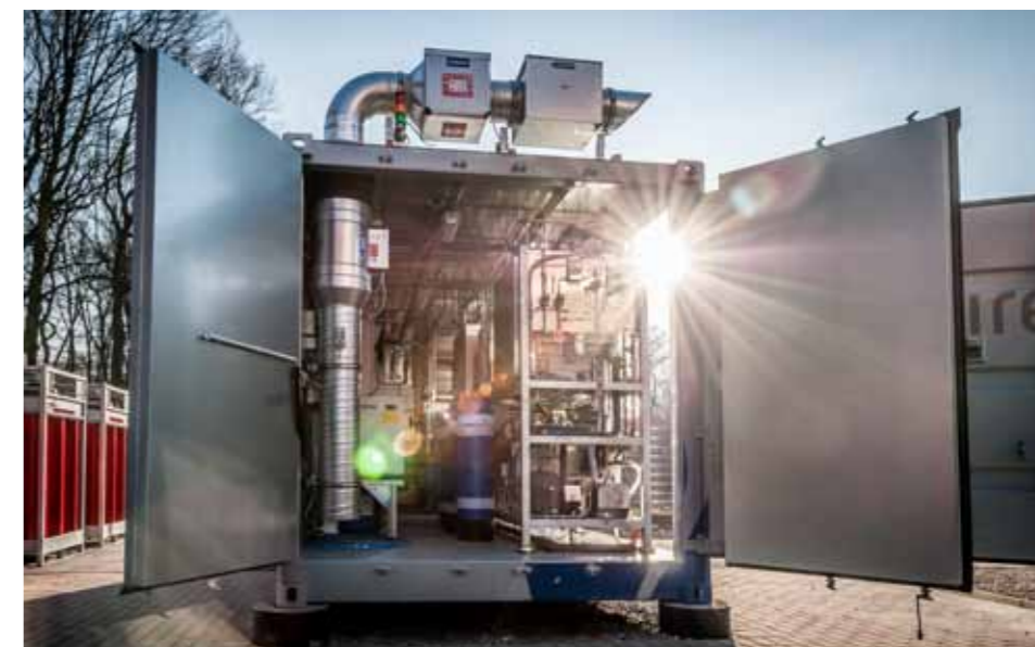
Elektrolyseanlage auf dem neuen Wasserstofftestfeld.
