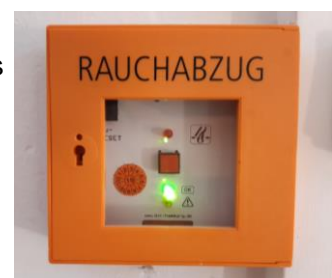
Auslösestation eines Rauchabzugs
