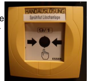
Auslösestation der Sprühflutlöschanlage
